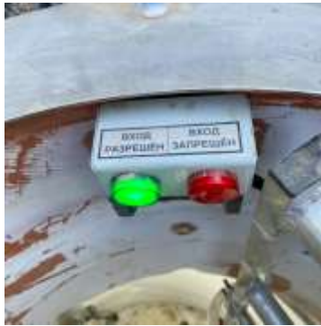
Индикация «Газов нет» под крышкой люка МС
