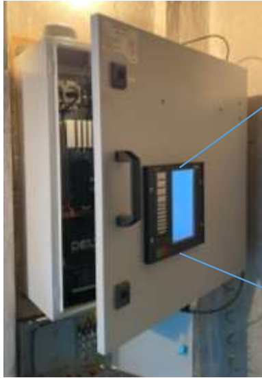
Шкаф телемеханики на ТП-2806
