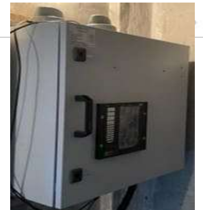
Шкаф связи на ТП 2806
